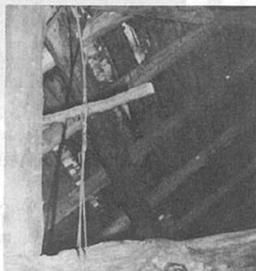
応急措置のまま老朽化した母屋
